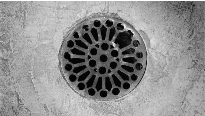
Abb. 8: Der riechende Abfluss.
