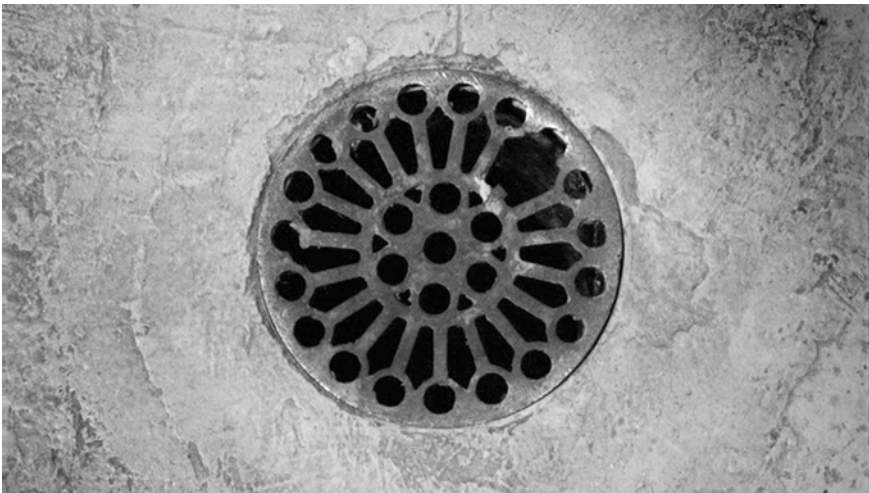
Abb. 8: Der riechende Abfluss.
