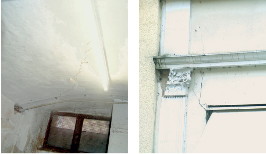
Bild 85 ■ Schadensbilder: Riss in Kellergewölbedecke (links) und Fassadenriss an der Grenze zum Neubau (rechts)
