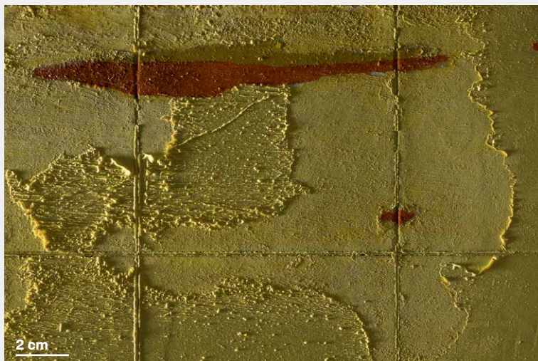
Abb. 4.11 Detail Malschichtschaden im Streiflicht.
