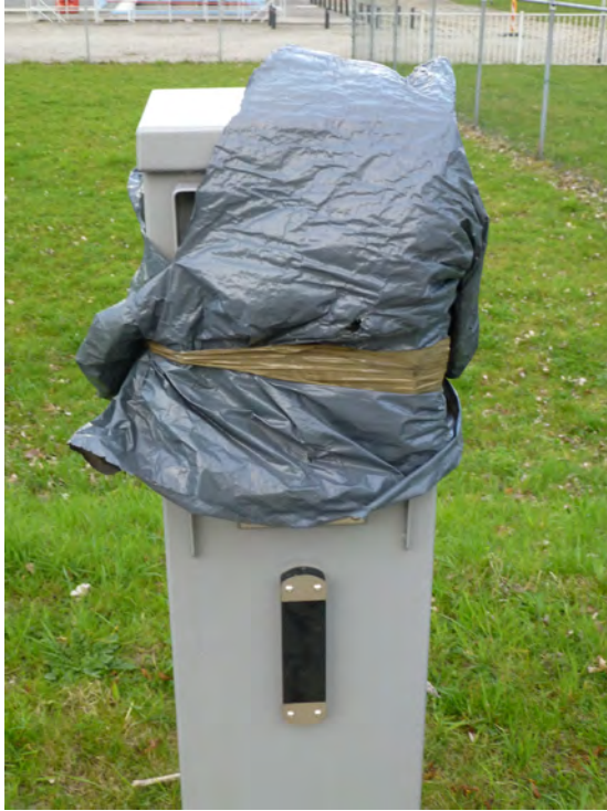
Abb. 3: Gegensprechanlage der Leitstelle von Terneuzen
