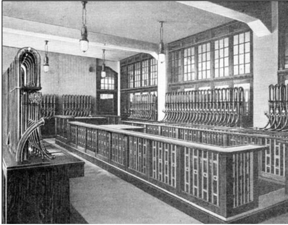
Abb. 8: Hausrohrpostzentrale des Kaufhauses des Westens, Berlin
