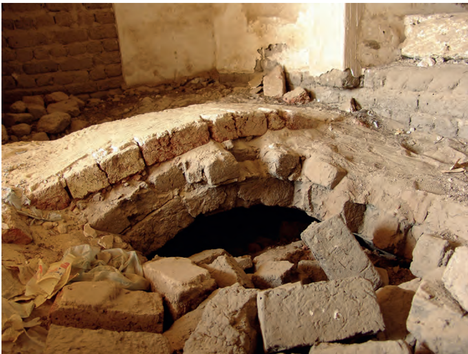
Abb. 8: Gewölbeausbruch im Fußboden in Raum GB 6.2.3; 2006
