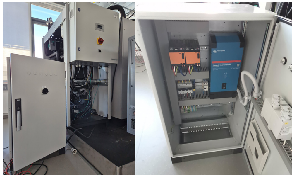
Bild 1 Links: Zusätzlicher Schaltschrank der hybriden Kältemaschine und die Kältemaschine. Rechts: Innenansicht zusätzlicher Schaltschrank. Fotos: EEP Uni Stuttgart
