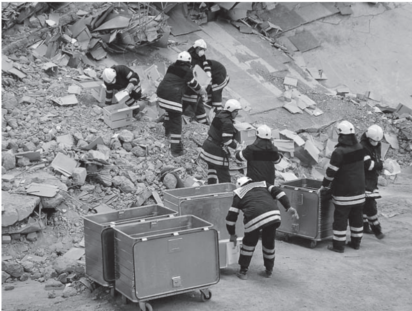
Bergungsarbeiten der Berufsfeuerwehr Köln am Fuß des Schuttkegels
