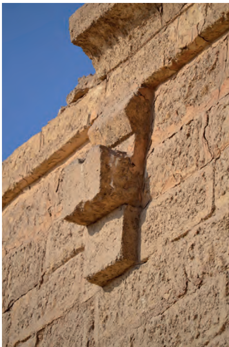
Abb. 6 a: Wasserspeier an GB 48, Seitenansicht; 2021
