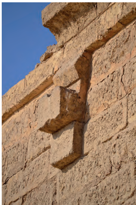
Abb. 6 a: Wasserspeier an GB 48, Seitenansicht; 2021
