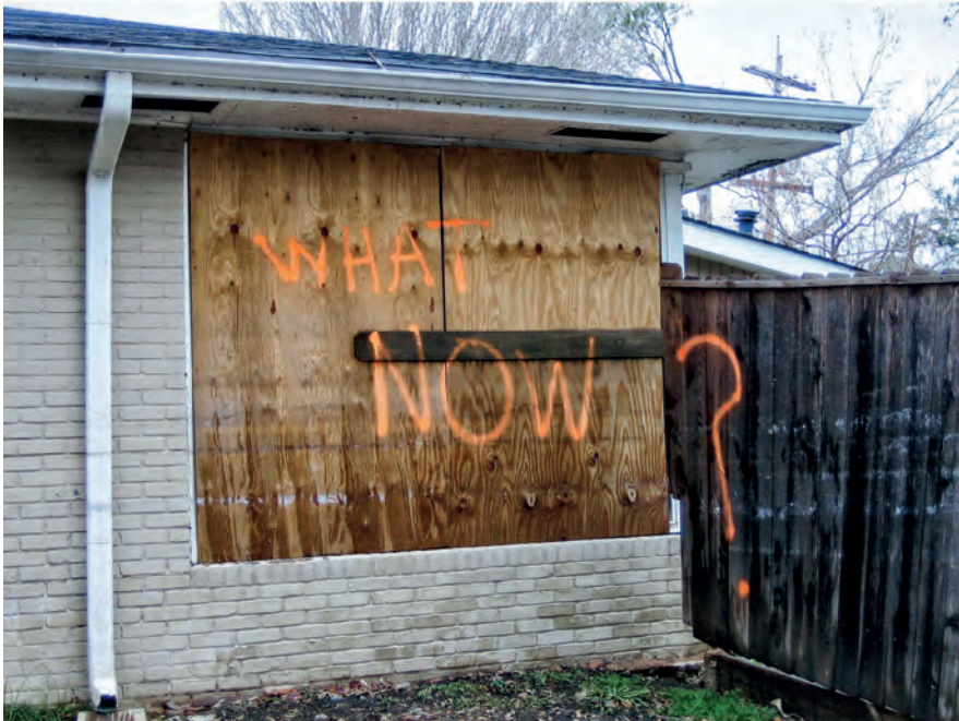
Abb. 1: Auf Gebäude gesprühte Graffiti zeigen öffentlich im Straßenraum die Auseinandersetzung mit den Schäden einer Naturkatastrophe. Die spezifische Botschaft dieses Schriftzugs lässt sich auf andere Bestandsbauten übertragen. Untitled [New Orleans and the Gulf Coast, 2005] (Foto: © Richard Misrach; Courtesy of Fraenkel Gallery, San Francisco; Pace Gallery, New York; Marc Selwyn Fine Art, Los Angeles)
