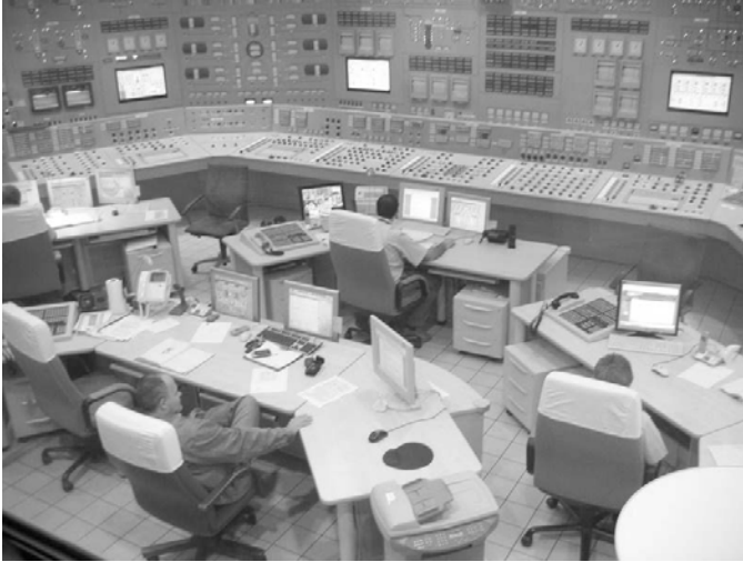
Abbildung 13: Kontrollraum des Kernkraftwerkes Paks in Ungarn.
