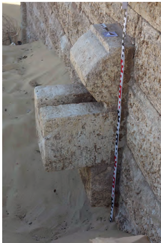
Abb. 4 a: Wasserspeier an GB 14, Ansicht von Süden; 2021
