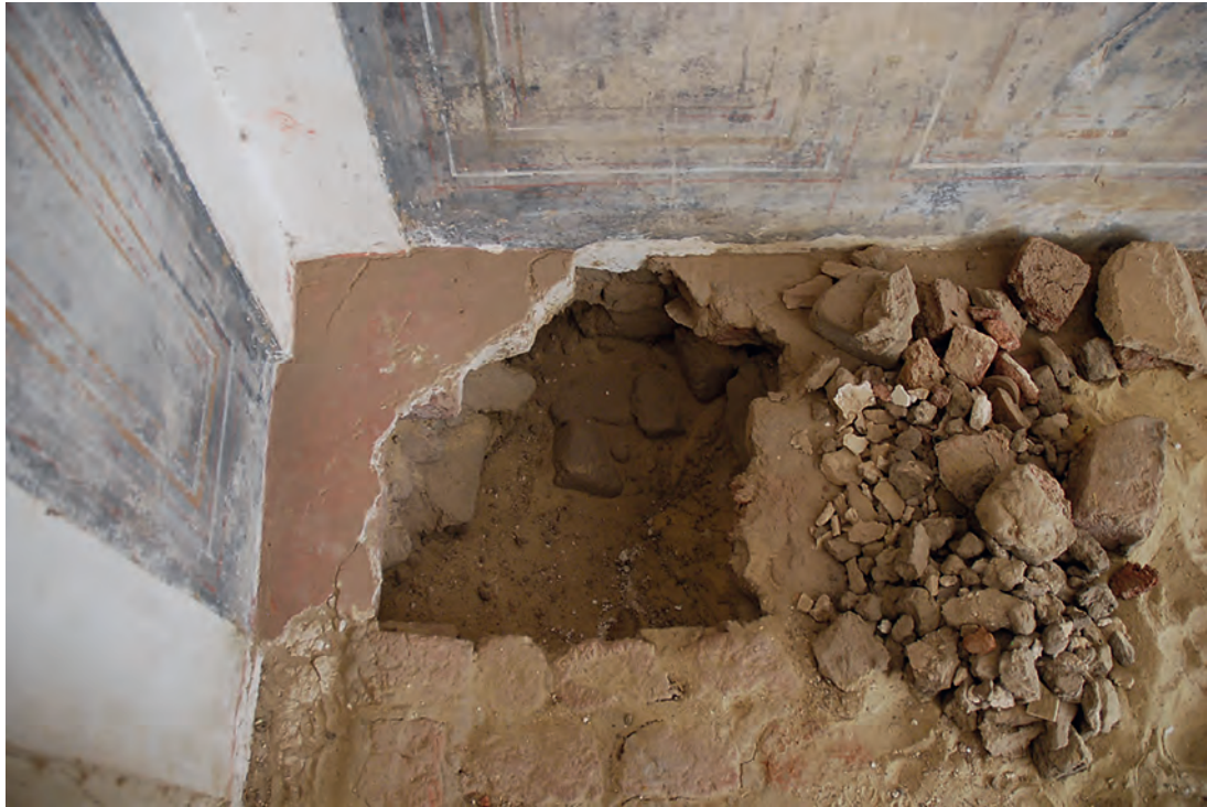
Abb. 14: Hauptraum, Ausbruch im Fußboden in Südwestecke; 2009
