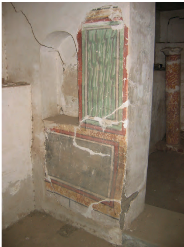
Abb. 11: GB 13, Obergeschoss, 1. Raum, östliche Süd- wand; 2006
