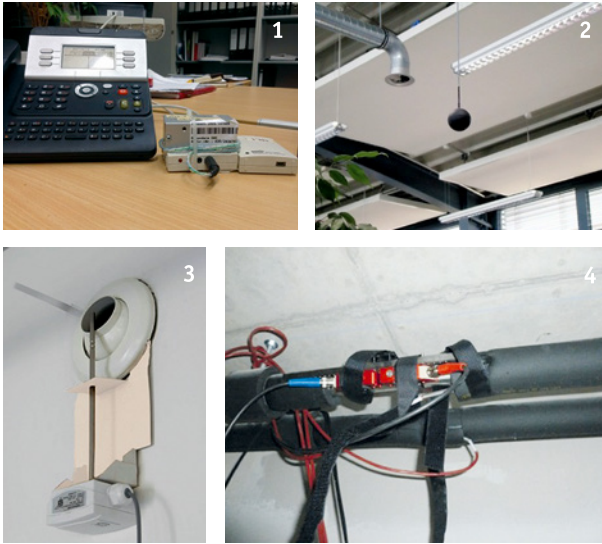
Bild 72: Beispiele für mobile Messtechnik zur Erfassung des Raumklimas und des thermischen Kühlergiebezugs; von links nach rechts: 1) Temperatur am Arbeitsplatz, Luftfeuchte und Beleuchtungsstärke, 2) operative Raumtemperatur, 3) Zulufttemperatur, 4) Vor- und Rücklauftemperatur und Volumenstrom des Kühlkreises [Quellen: Fraunhofer ISE und fbta Karlsruhe]
