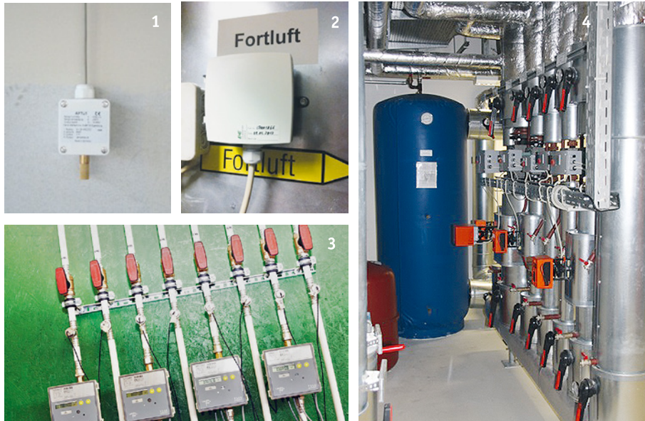
Bild 73: Beispiele für fest installierte Messtechnik; von links nach rechts: 1) Raumtemperatursensor, 2) Lufttemperatur in der Lüftungsanlage, 3) Wärmemengenzähler (inkl. Temperatur), 4) Pumpen- und Ventilzustand in der zentralen Wärme- und Kälteverteilung [Quellen: Fraunhofer ISE und Hochschule Offenburg]
