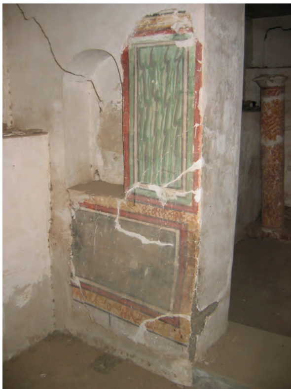
Abb. 11: GB 13, Obergeschoss, 1. Raum, östliche Süd- wand; 2006
