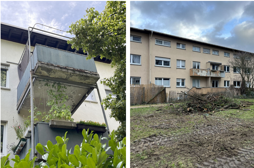
Abbildung 10 und 11: Marode Balkone (links), bröckelnder Putz an der Rückwand eines Wohnblocks (rechts) (Juni 2022)
