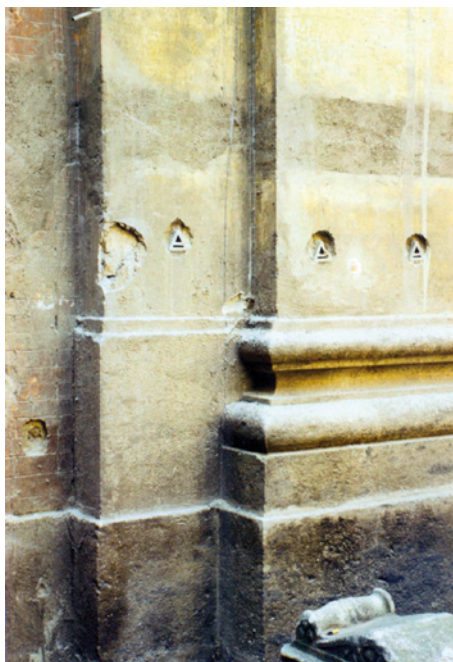
Bild 5: Teilansicht der Erdgeschoss-mauer des Nationalmuseums in Nepal, fotografiert 1974. Man kann sich fragen, ob dort aufsteigende Feuchte wirklich die Ursache sein konnte.
