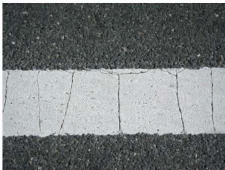
Bild 32: Risse in einer Straßenmarkierung, die nicht durch den Straßenbelag verursacht sein können, sondern durch Schwindspannungen in dem nachträglich aufgetragenen kunststoffgebundenen Belag von einigen Millimetern Dicke. Offensichtlich ist in der Breite der Markierungstreifen ein rissfreies Schwinden möglich, das aber in der Längsrichtung zu Rissen etwa im Abstand des Breitenmaßes zur Folge hat.
