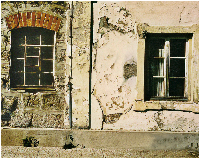
Bild 8: Bei der Tuffstein-Außenwand eines alten bäuerlichen Anwesens tritt nur im Außenputz des Wohnbereiches aufsteigende Feuchte auf, nicht aber im unverputzten Bereich, trotz höherer Feuchtebelastung (Stall).
