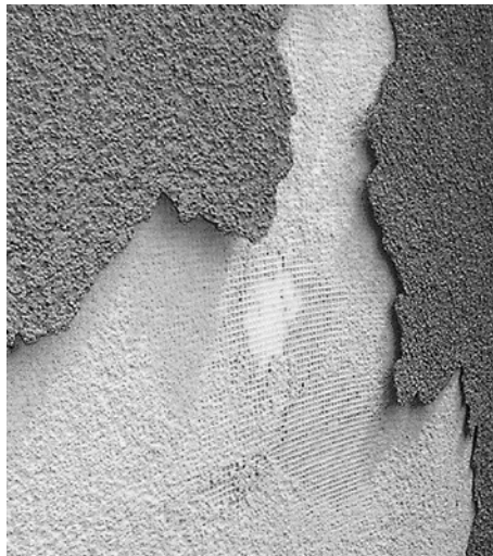
Bild 42: Ablösung des Kunstharz-Oberputzes von dem vorwiegend mineralisch gebundenen Armierungsputz mit zu unterschiedlichen Formänderungstendenzen bei einem WDV-System, wobei die Haftfestigkeit infolge Frosteinwirkung gemindert worden ist.
