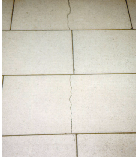
Bild 34: Risse in Werkstein-Bodenplatten, hervorgerufen durch Fugen benachbarter Plattenlagen, die als Kerben wirkten
