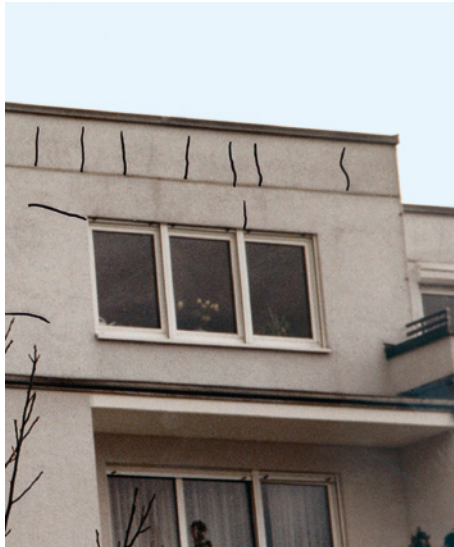
Bild 31: Teilansicht eines Wohngebäudes mit Flachdach; Außenwände aus Porenbeton, Attika Normalbeton mit Außendämmung durch WDV-System. Im Putz der etwa 50 cm hohen Attika sind vertikale Schwindrisse aufgetreten, da der Putzgrund EPS nicht ausreichend als »Armierung« wirkt (Risse nachgezeichnet).
