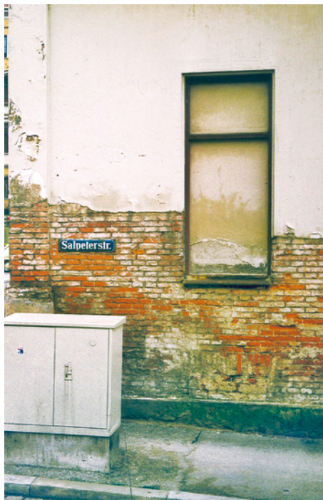
Bild 2: Teilsicht der Außenwand der früheren Salpeteraffinerie innerhalb des Gebäudekomplexes der ehemaligen Königlichen Residenz in München mit typischen Putzschäden infolge Salzausblühungen. Die an die Raffinerie angrenzende Straße hatte den Namen »Salpeterstraße«. (Foto: H. G. Meier)
