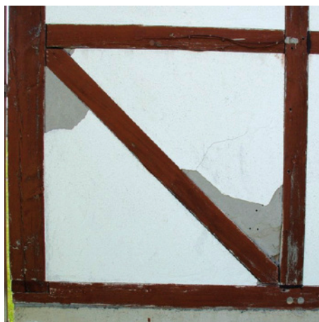
Bild 37: Putzablösungen an einer Ausfachung durch Gefachmörtel am Fachwerkhaus in der Freiland-Versuchsstelle des Fraunhofer IBP, Holzkirchen. Die Ablösung erfolgt besonders in den ›Zwickeln‹ mit nahe gegenüberliegenden Ablösungstendenzen.
