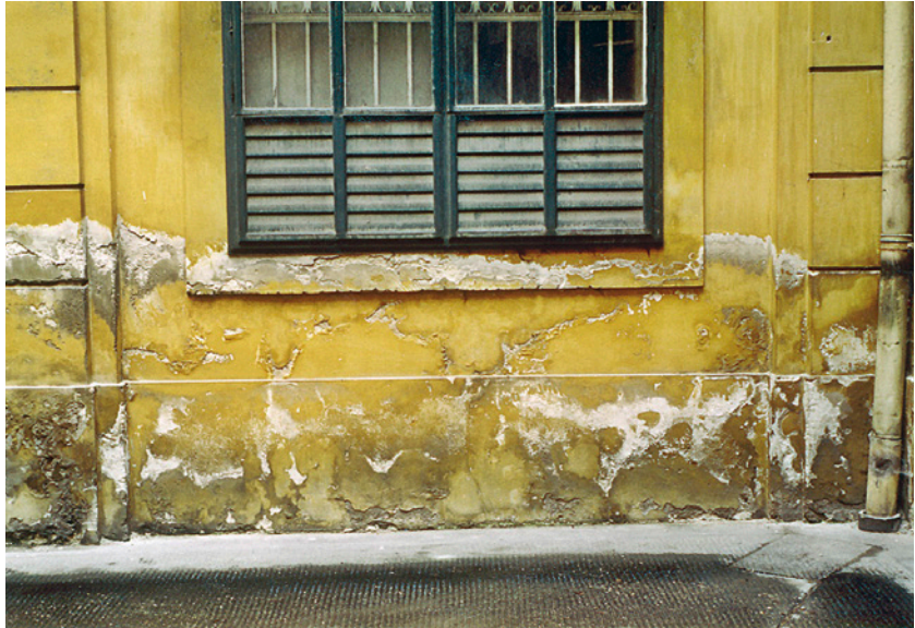
Bild 1: ›Aufsteigende Feuchte‹ an einem alten Gebäude: Der untere Wandbereich ist dunkler (feuchter?), dann folgen weiße Salzausblühungen und Putzabsprengungen.
