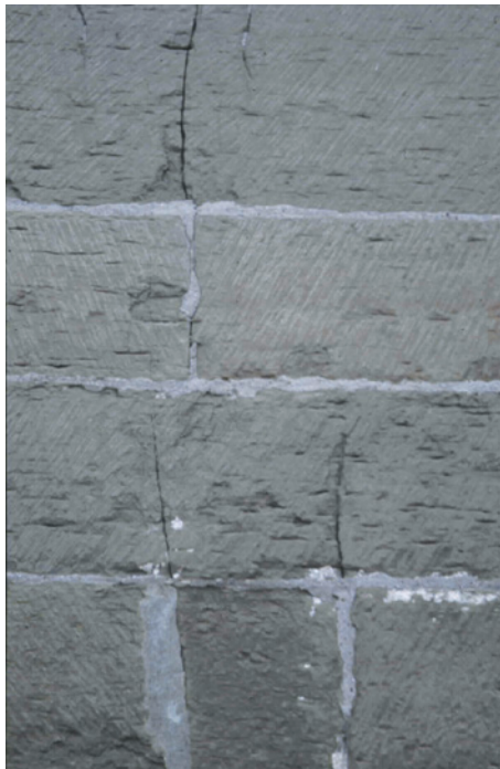
Bild 35: Vertikale Steinrisse infolge Kerbwirkung der benachbarten Stoßfugen bei Sandstein-Außenmauern einer Kirche in Herrenberg
