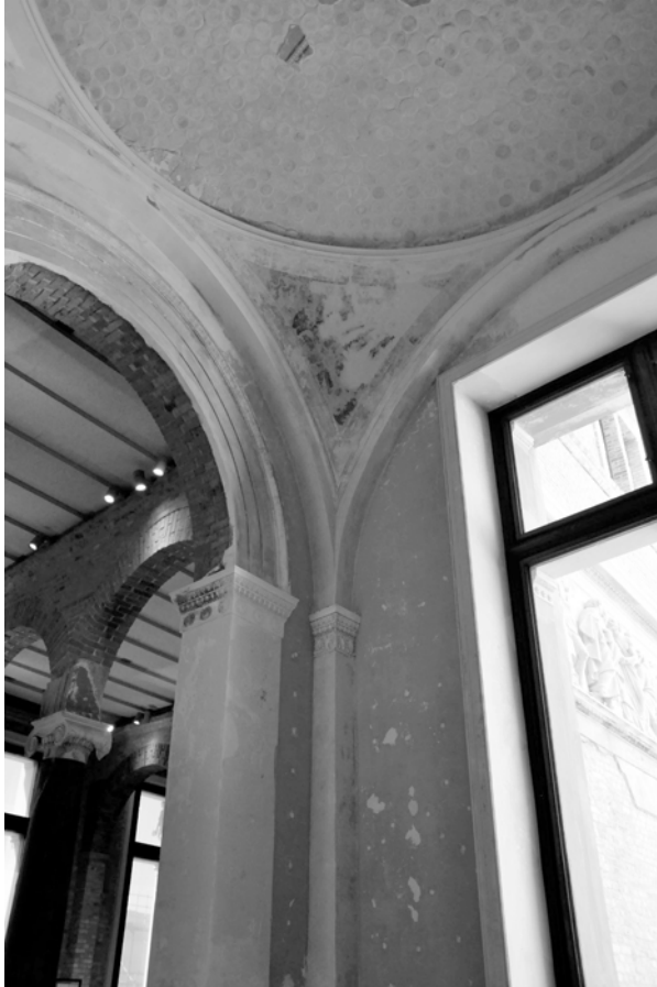
Abbildung 21: Der Blick vom Mittelalterlichen Saal in den Modernen Saal (links) und den Griechischen Hof (rechts) zeigt die Vielzahl der Schadensformen und Zeitschichten, auf die die Wiederherstellung rekurriert.
