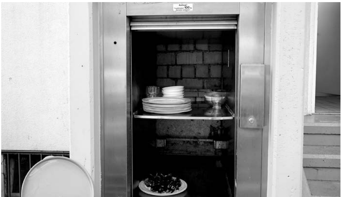
Abb. 2 Speiseaufzug in der Akademie der Arbeit. Foto: Marc Behrens
