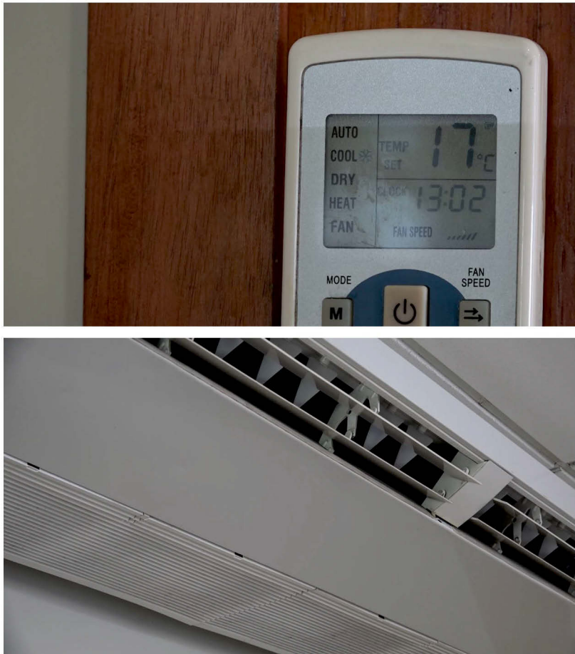
Abbildung 25: Detailansichten des Temperaturreglers und der Klimaanlage
