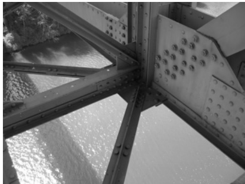
Abb. 1: Eisenbahnbrücke über den Rhein bei Eglisau, Ersatz von Nieten durch Schrauben. Foto: Werner Köhler.
