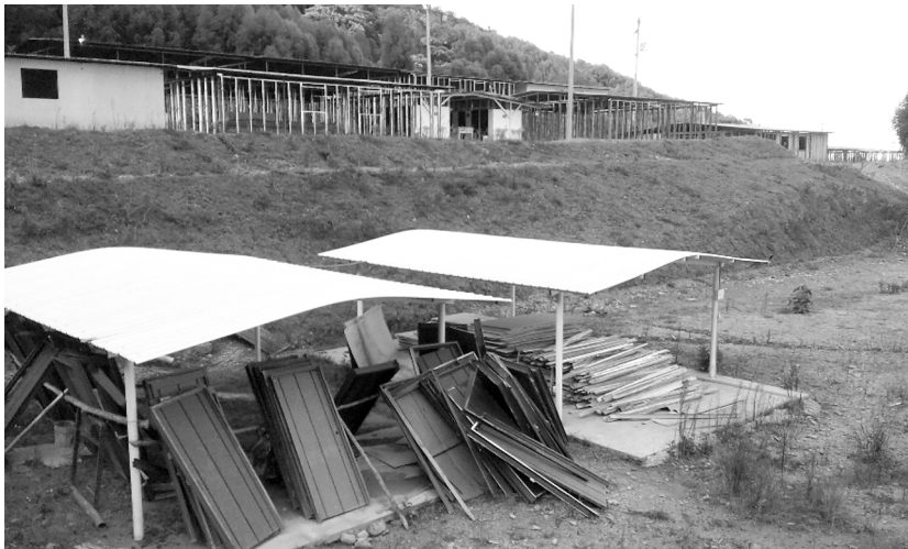
Foto 5: Nicht fertiggestellte Baracken, La Elvira
