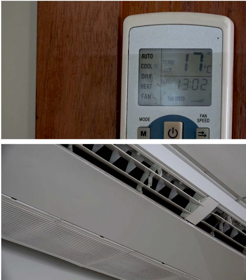
Abbildung 25: Detailansichten des Temperaturreglers und der Klimaanlage
